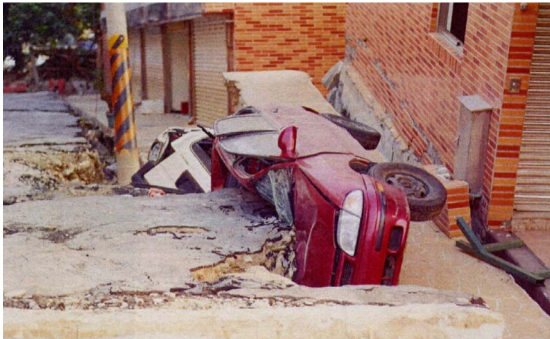
Фото 2. Косейсмическое открытие и закрытие трещины во время землетрясения Чи-Чи (М 7.7) происшедшего в 1999 г в центральной части о. Тайвань. Автомобили, припаркованные вдоль трещины, провалились и получили серьезные повреждения. Фото Геологической Службы Тайваня.
