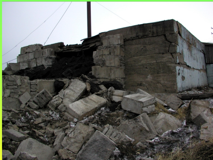
Рис.10. Село Тилички. Разрушение котельной.
