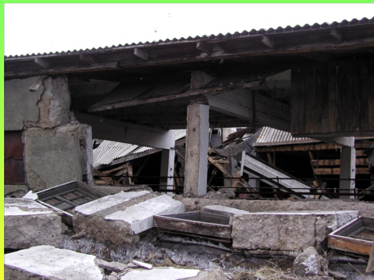
Рис.9. Село Тилички. Разрушение мелкоблочных бетонных зданий в северной части поселка.
